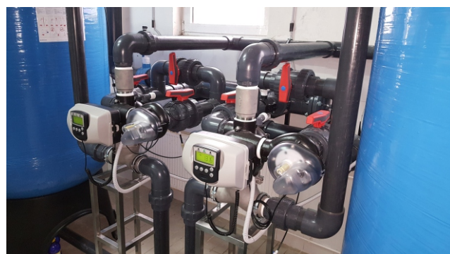
Automatski deferizator u paralelnom radu sa Clack WS3CI upravljачkim ventilima
